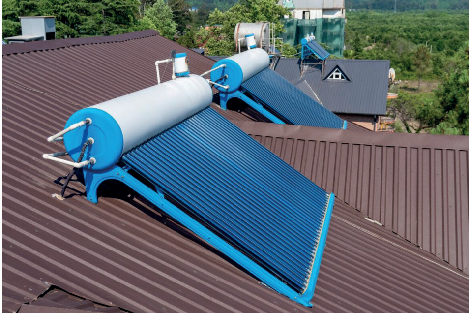
Figura 3: Calentadores de agua solares instalados en tejados
